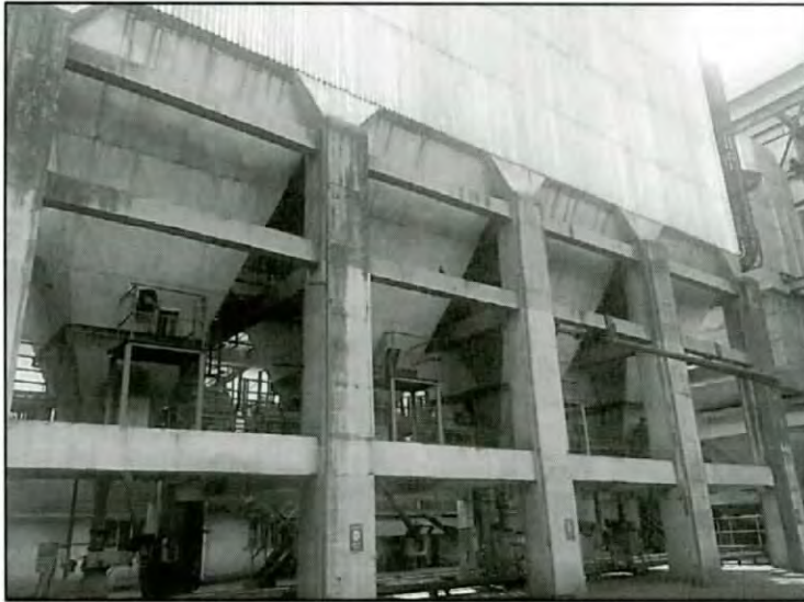
ESP at TTP 15 MW
